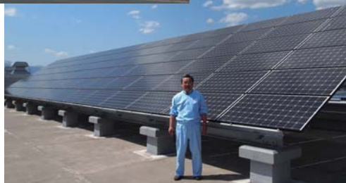
福島工場の太陽光発電設備
