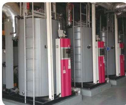
天然ガスボイラー
