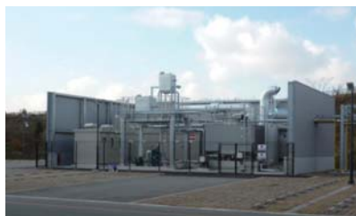
兵庫三木工場の コージェネレーション設備
