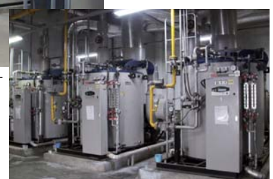
スラバヤ工場ボイラー (インドネシアヤクルト株式会社)
