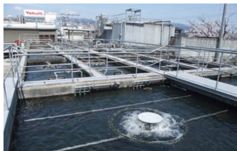
佐賀工場・水浄化システム
