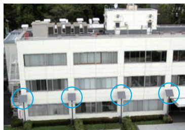
太陽光発電システム
