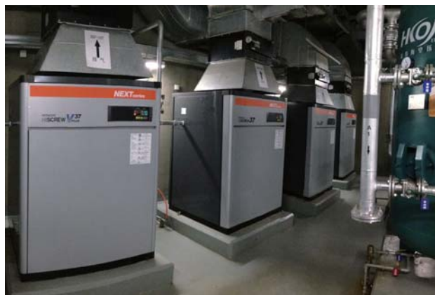
天津工場コンプレッサー(天津ヤクルト株式会社)
