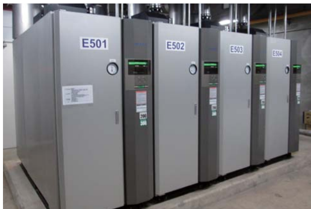
中歴工場ボイラー(台湾ヤクルト株式会社)
