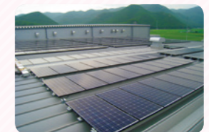
工場屋上に設置された太陽光発電 (岡山和気ヤクルト工場)
