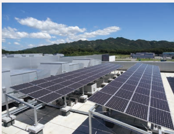
屋上に設置した太陽光発電設備
