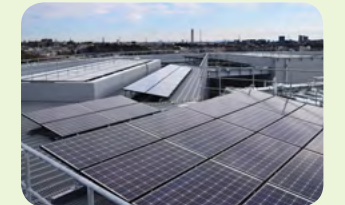
中央研究所の太陽光パネル
