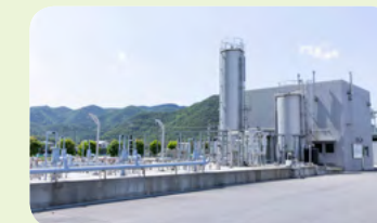
排水処理施設
