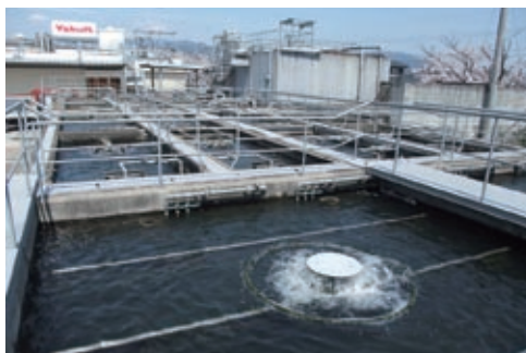
佐賀工場・水浄化システム（佐賀工場は、2012年1月16日より下水道への接続となり、2012年3月末現在、水浄化システムは撤去されています。）
