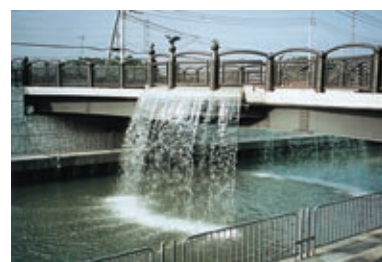
東京都垢川平成泉橋水処理施設
