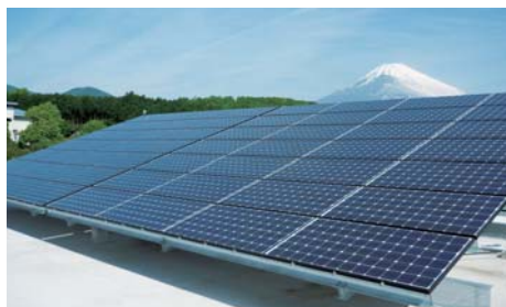
富士裾野工場の太陽光発電設備
